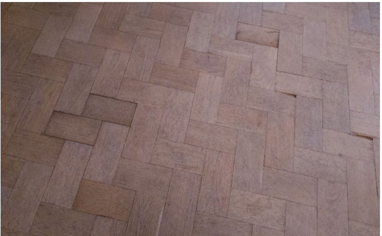
FOTO 2. Kahjustatud ja vahetatud liistud
